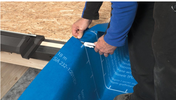
17. Seitlich am Aufkeilrahmen die Bahn aus der Fläche hochführen. Alternativ einen neuen Streifen SOLITEX WELDANO ablängen, am Aufkeilrahmen hochführen und unten auf der flächigen Bahn schweißen.
