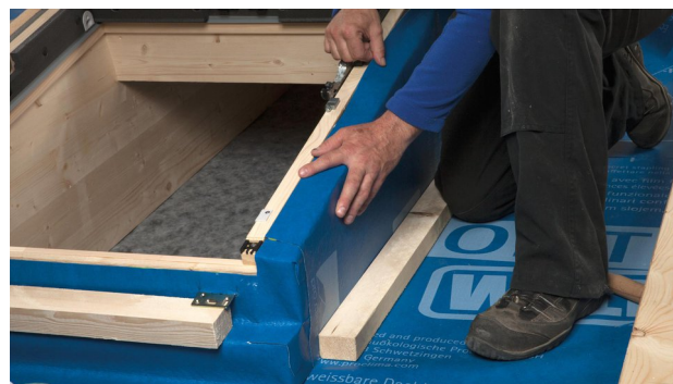
22. Coller SOLITEX WELDANO le long bord du châssis. Poser l'écran avec une boucle de dilatation dans le lit de colle. Ne pas aplatir complètement la colle, afin de permettre une compensation des mouvements de l'ouvrage.
