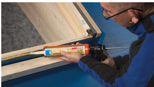
7. Appliquer un cordon de colle ORCON CLASSIC d'au moins 6 mm de diamètre sur le support minéral (le cas échéant, davantage sur des supports rugueux) et coller SOLITEX WELDANO-S sur la partie inférieure du châssis de fenêtre.
